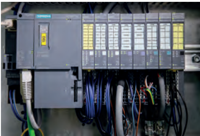
Gesteuert wird die Anlage über Simatic ET 200SP Module und Simatic S7-1500, ergänzt werden die Steuerungselemente von einem Sinamics G120 Frequenzumrichter.
